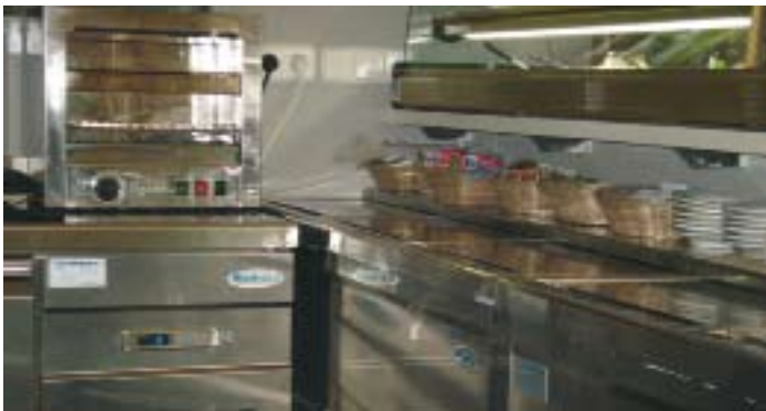
Cafetería Hospital Virgen del Consuelo. Trabajo realizado por Adequip.
