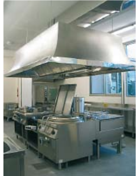
Cocina industrial. Trabajo realizado por Adequip.
